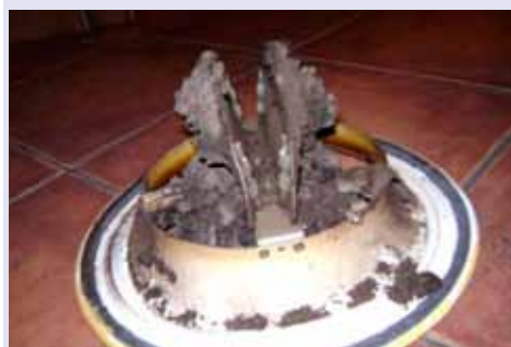
Los principios de contaminación se exteriorizan en rejillas y difusores. Tal y como muestran estas imágenes.
